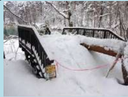
るり沼(展望デッキ破損)
