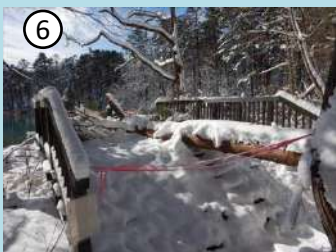
6 るり沼(展望デッキ破損)
