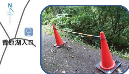
④危険箇所(崖側土砂崩れ)
