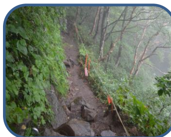
⑤崩落箇所
