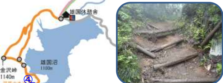
③階段の破損箇所あり
